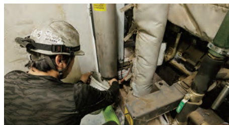
バイオマス発電にはフィンランドのメーカーである『VOLTER』の発電機を8基稼働。
