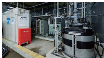
株式会社トヨタエナジーソリューションズが開発したアンモニアを燃料としたマイクロガスタービン(MGT)。
